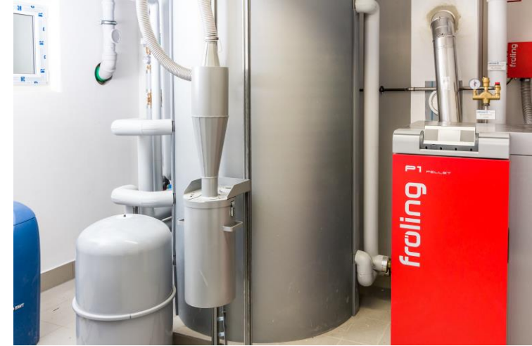
Pelletsheizung und Pufferspeicher
