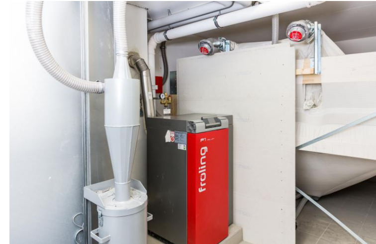
Pelletsheizung und Pelletsbunker
